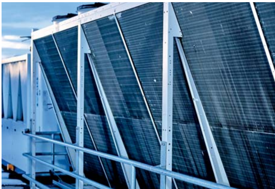
Großkälteanlagen müssen regelmäßig gereinigt werden, damit keine Energieverluste entstehen und Stromkosten minimiert werden können.
