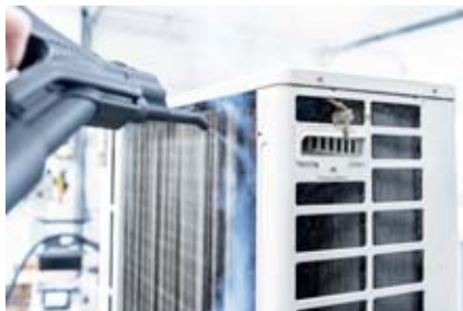
Für die schonende Reinigung der Lamellen von Wärmetauschern eignen sich Dampfsaugsysteme.
